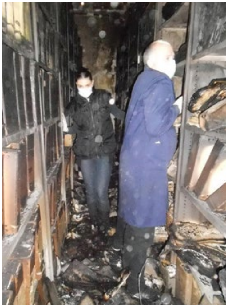
Posledica neopaženega požara v arhivskem depoju
